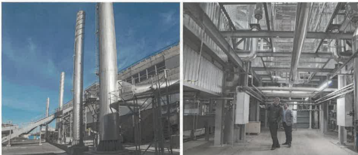
5.2. att. Katlumāja Talsu ielā 69, Ventspilī
